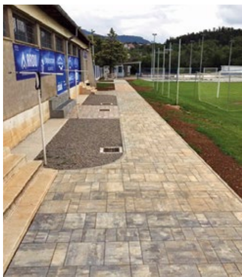
Izvedeni radovi oborinske odvodnje, uređene prilazne staze, nasipane zelene površine i promijenjen krovní pokrov na objektu NK "Naprijed"
